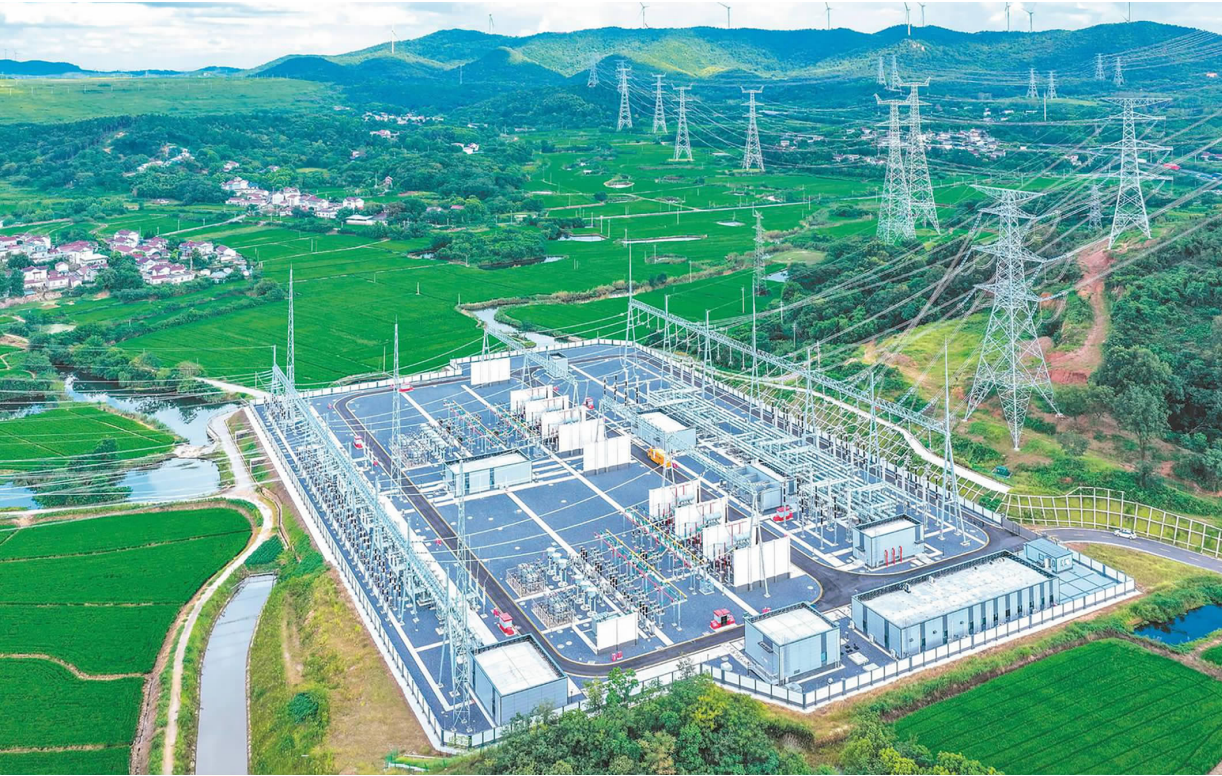
8 月 21 日,航拍的安徽马鞍山 500 千伏锁库变电站。该变电站今年 3 月正式投运后,有效优化了城市电网结构。(濮勇)
